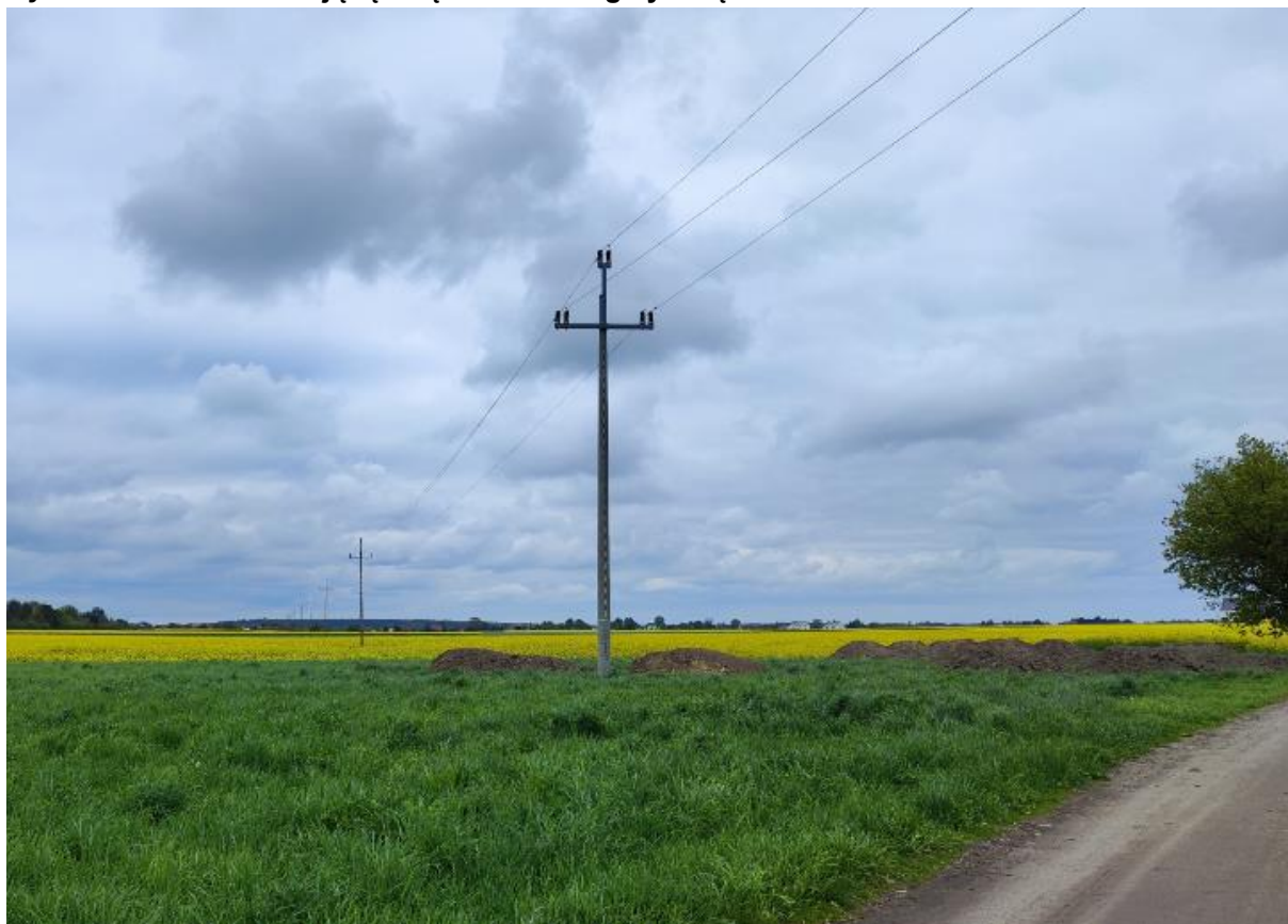
Ryc. 11 Widok na istniejącą linię elektroenergetyczną 15 kV
